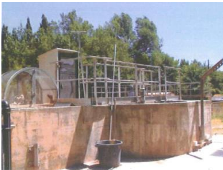
Prétraitement et dispositif de prélèvement « entrée de station »- Source : ARPE Synthèse annuelle des résultats d'auto-surveillance 2013
